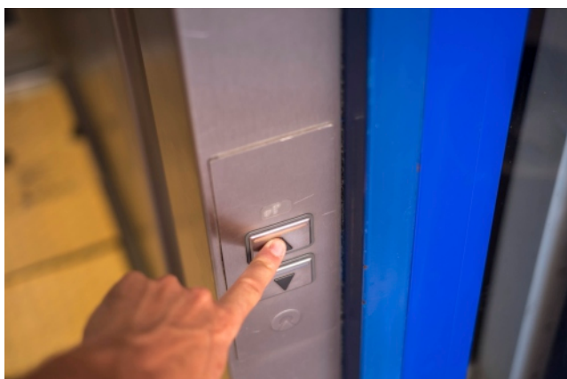
Privolání výtahu – 5. patro – apartmán G 5 A.
